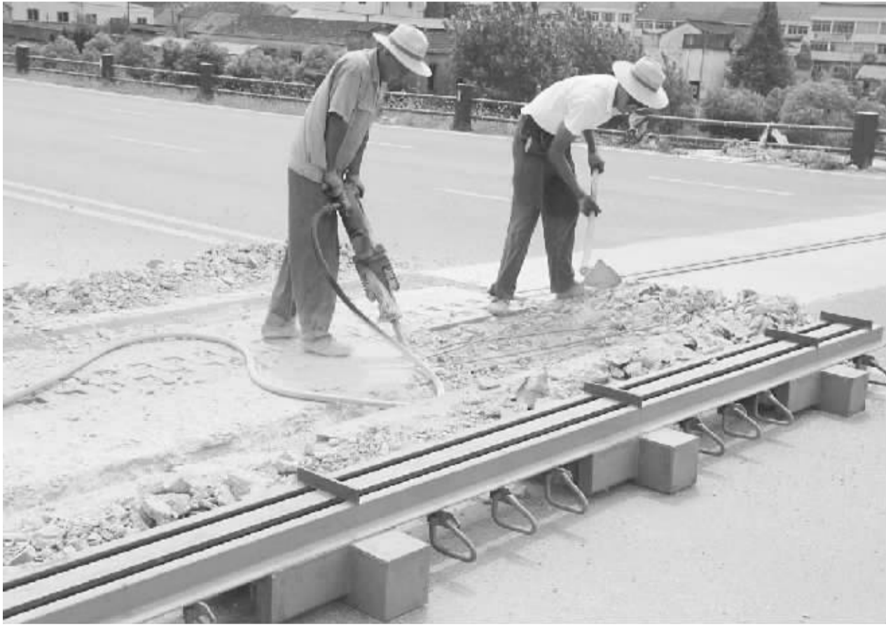
连日来,市公路部门施工工人冒着高温,加紧修复池青九快速通道五溪互通立交伸缩缝。因超限运输车辆行驶等影响,该桥日前发生伸缩缝部分损坏,所幸被巡查养护工及时发现。市公路部门及时投入80万元对其进行修复,预计8月底可全部修复完毕。据悉,市公路部门已经派出公路桥梁安全巡查小组对境内国省干线桥梁进行为期一周的大检查,全面排查公路桥梁安全隐患。 周俊 摄
